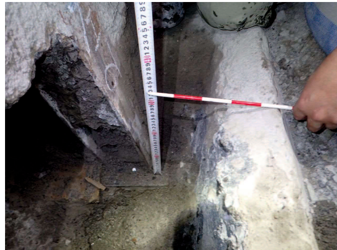
・ 鋼製支保工がインバート内に食い込んでいる。
