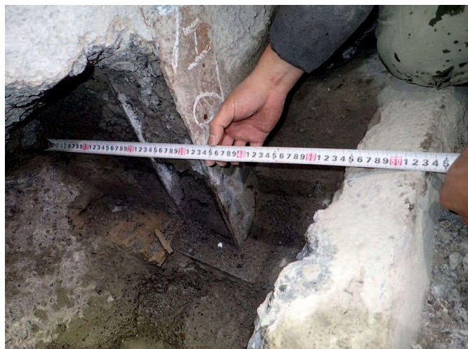
・ インバート前面から約330mmの位置に鋼製支保工前面がある。
