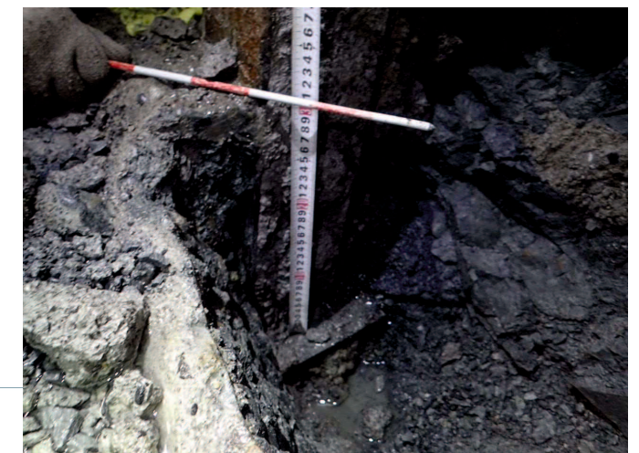
・ 鋼製支保工がインバート内に食い込んでいる。
