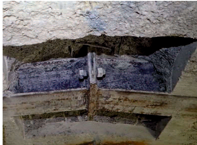
・ 天端継ぎ手ボルトの締結不良の例 (S034)
