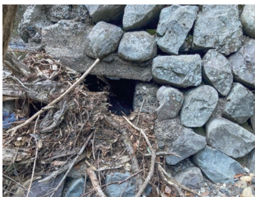
暗渠状の穿孔
