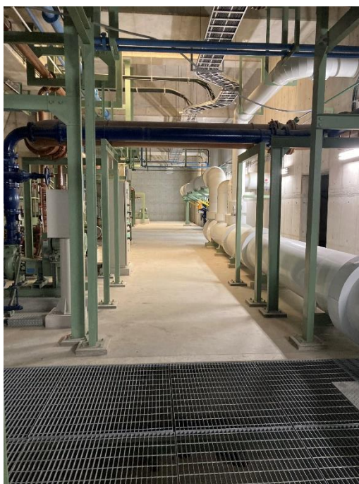
【塩素混和施設】
