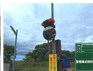
竜川水位警報機点検
