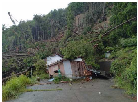
【家屋被災状況】
