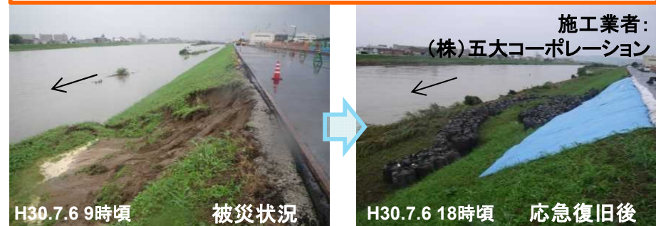
堤体漏水<奈佐川右岸2.4k(豊岡市)>
