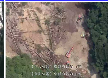
倒木・流木撤去状況<7/25時点>
