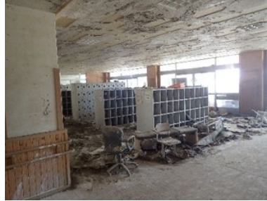
平成30年7月豪雨の被害
