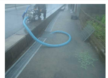
稼働時況(出水時)
