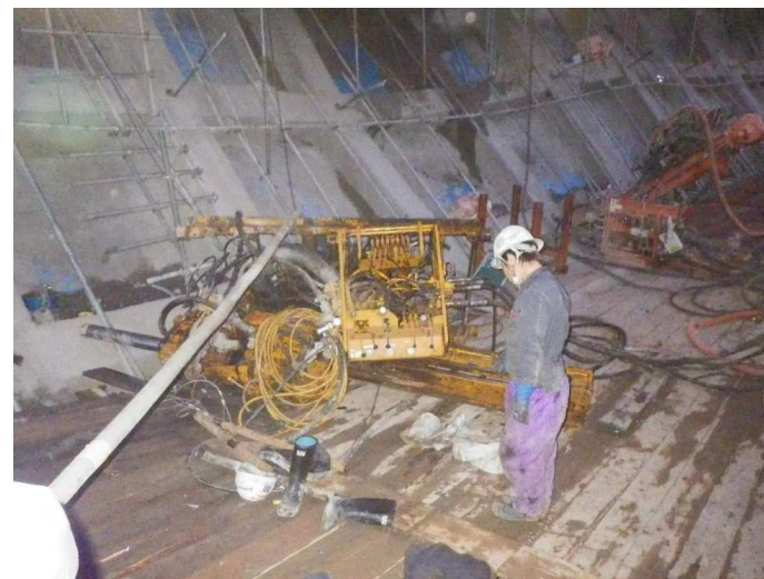
【 事故現場写真 】
