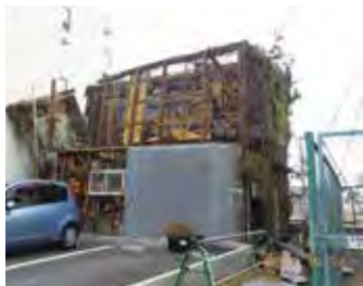
(神戸市内：台風による空き家の倒壊)
