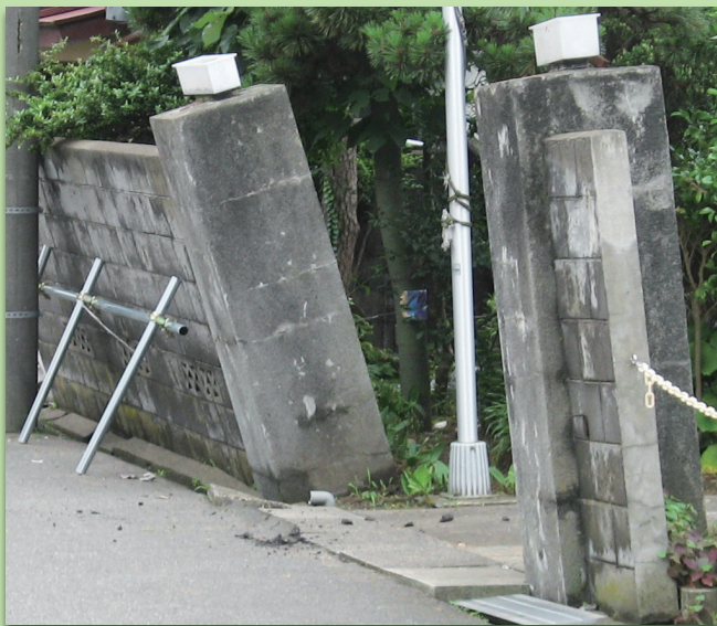
基礎の根入れ不足等により傾いた状態。 電柱により転倒をまぬがれている。
