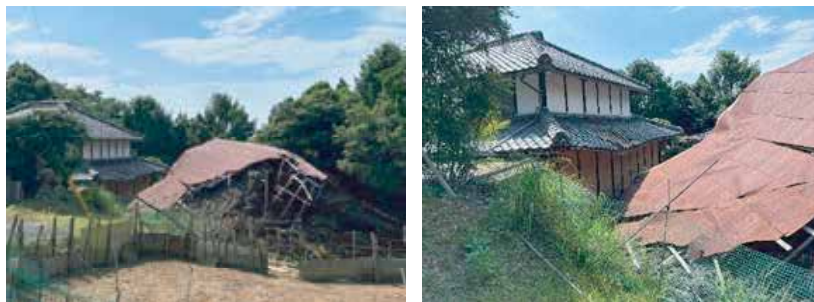
(兵庫県内：老朽化による空き家の自然倒壊)
