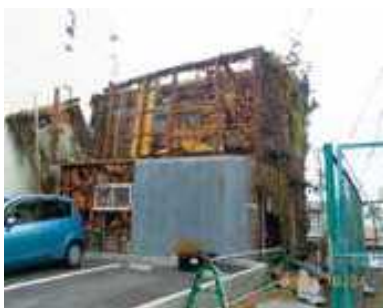
(神戸市内：台風による空き家の倒壊)
