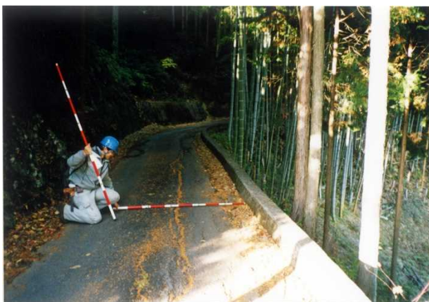
図IV- 4.5 変状確認調査
