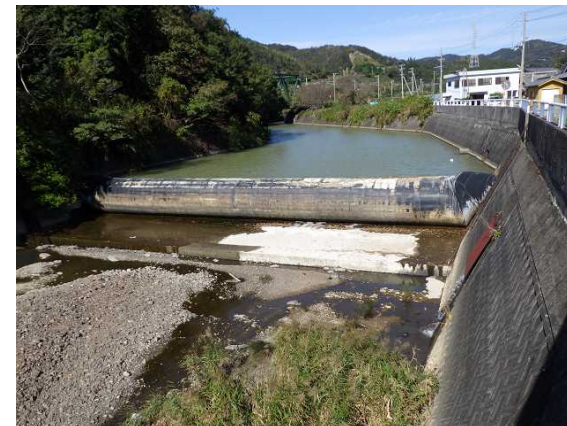
ゴム引布制起伏堰（2.9k付近）
