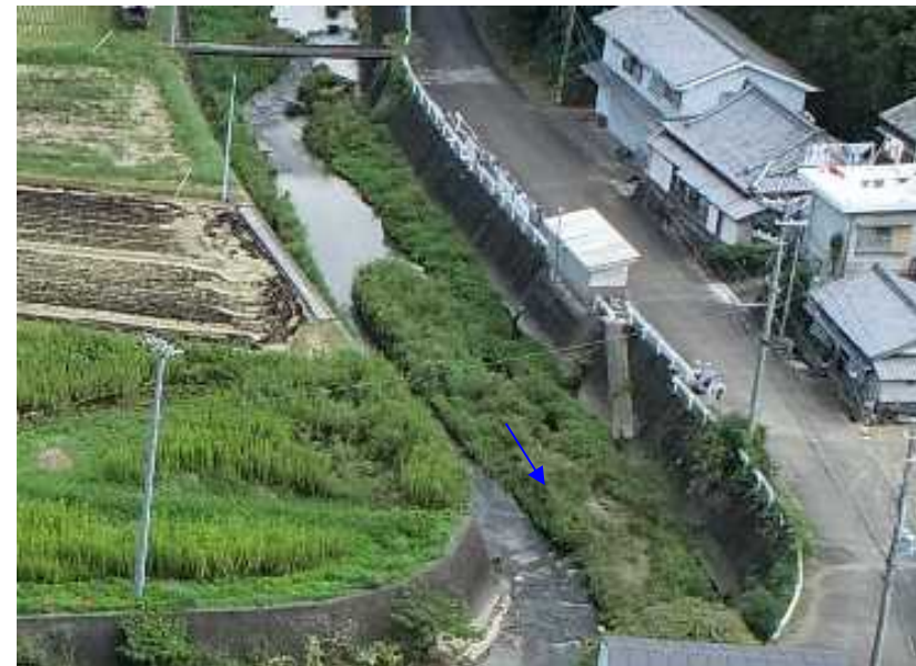
印南川5. 2k付近 土砂堆積状況
