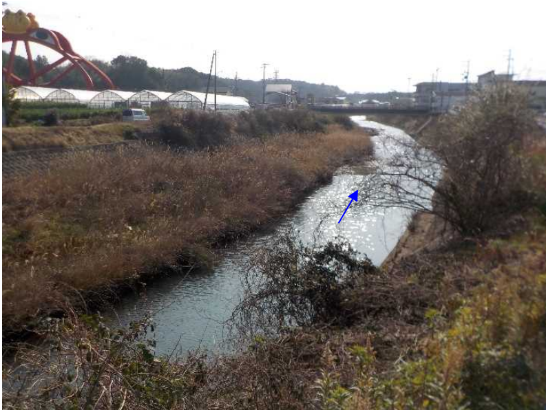
印南川1. 2k付近 樹木繁茂状況
