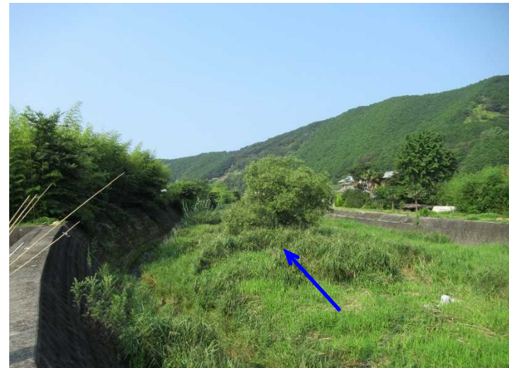
太間川 樹木繁茂状況
