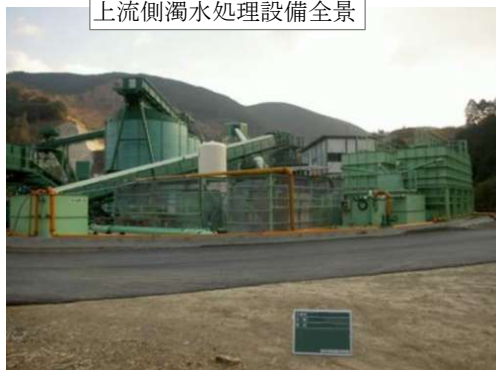
上流側濁水処理設備全景
