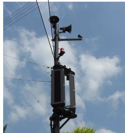
警報装置(電光掲示板付)
