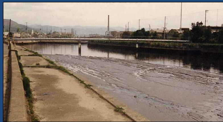
和歌川ヘドロ堆積 小雑賀橋仮堰上流付近
