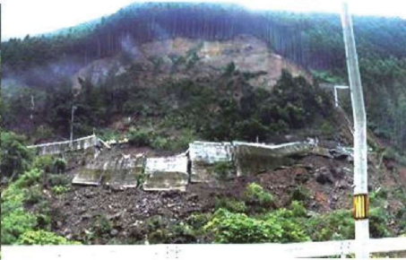
崩壊後(2004年8月10日)
