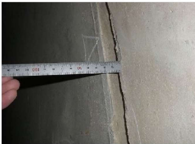
写真-解 7.8 段差の例
