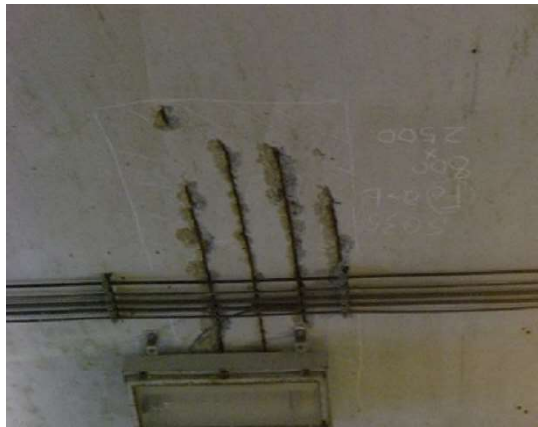
写真-解 8.2 鋼材腐食の例
