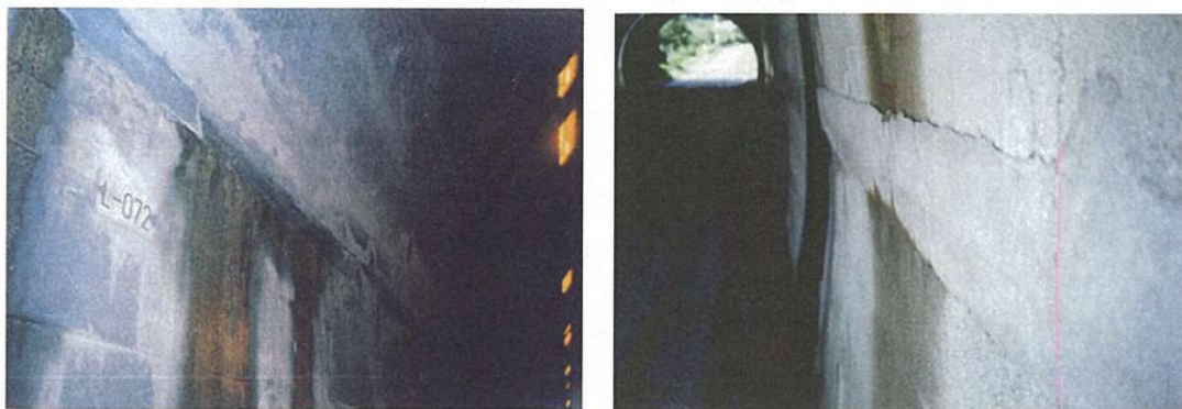
写真-解 7.2 逆巻き工法の縦断方向打ち継目と化粧モルタルの施工状況
