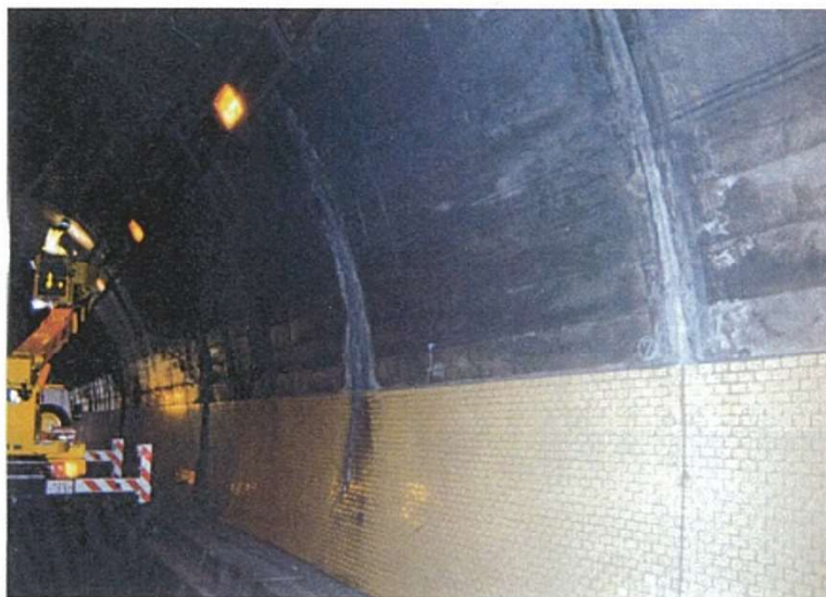
写真-解 7.4 覆工スパンの中間付近に発生したひび割れの例
