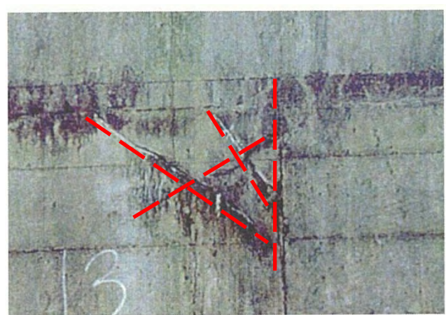
写真-1 ブロック化したひび割れの例
