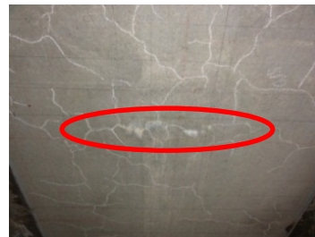
貫通ひびわれあり
