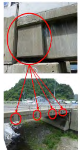
覆水切りが桁下まで打ち下ろさないため、横桁位置が確認する。
