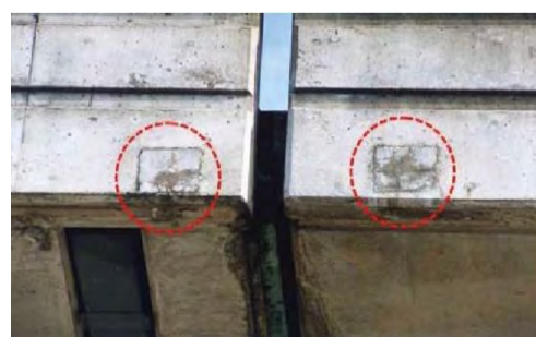
写真 2.4 ひび割れ、漏水 (定着部)
