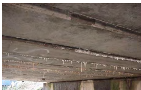
写真 2.3 遊離石灰 (間詰め部)
