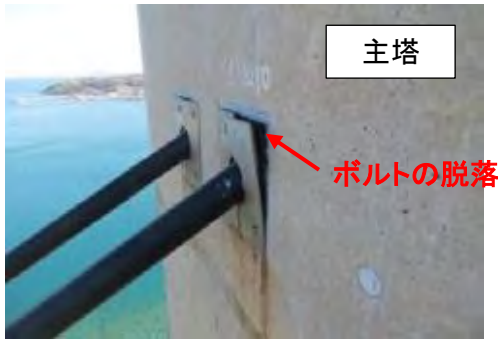
写真は、サドル部保護カバーの損傷事例
