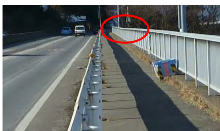
※写真は中央ヒンジを有する橋梁に異常なたわみが生じている事例。
