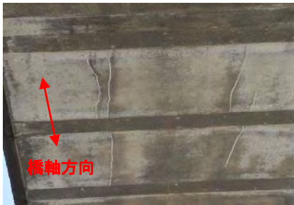
※写真は吊床版橋下面のひびわれ事例
