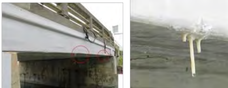
写真 2.6 補強材からの漏水の例
