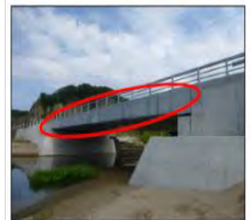
※地覆水切りが桁下まで打ち下ろされているため、横桁位置が確認できない。
