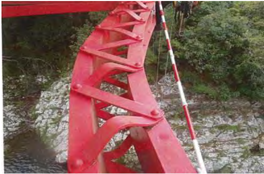
接合部の破断
