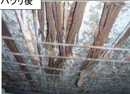
※写真はPC桁下面のひびわれ事例
