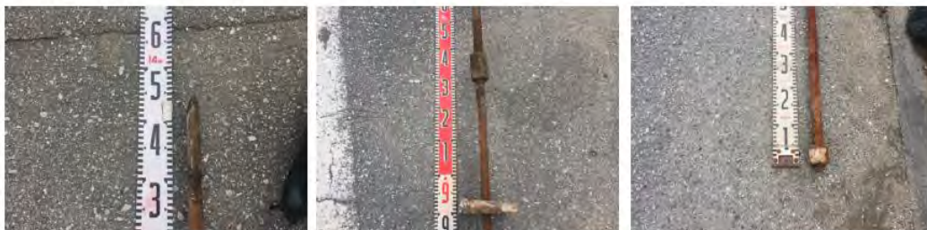
図 1.3 PC 鋼棒の突出後に再度突出が生じた事例
