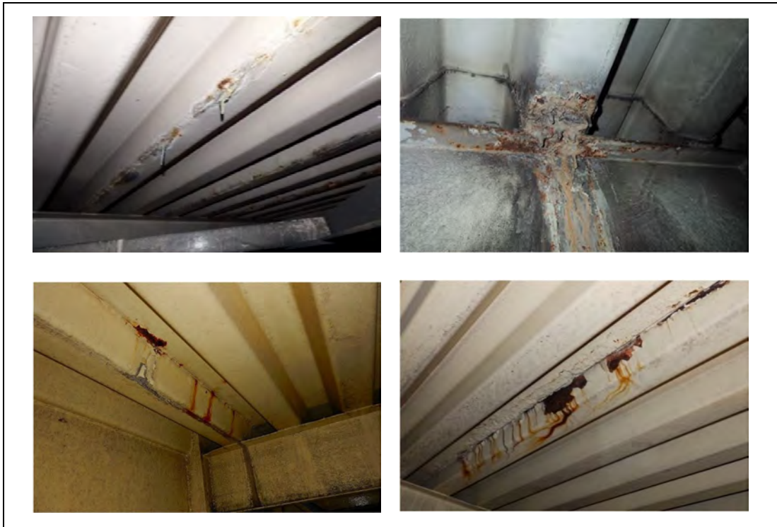
床版（デッキプレート）に漏水がある場合の例
