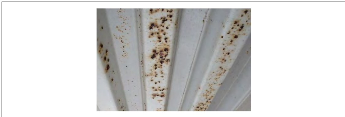
損傷の面積が大の例（着目部分の50%以上に錆が生じている又は局所的な錆が着目部分内に多数発生して結果として着目部分の範囲内で拡がっている例）
