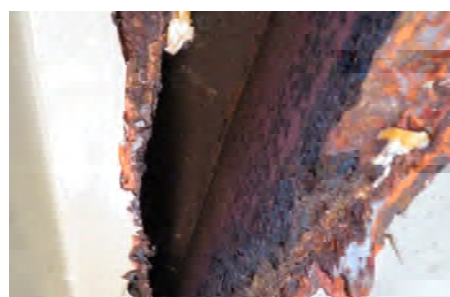
※ 腐食片を除去した後の主桁腹板の状態
