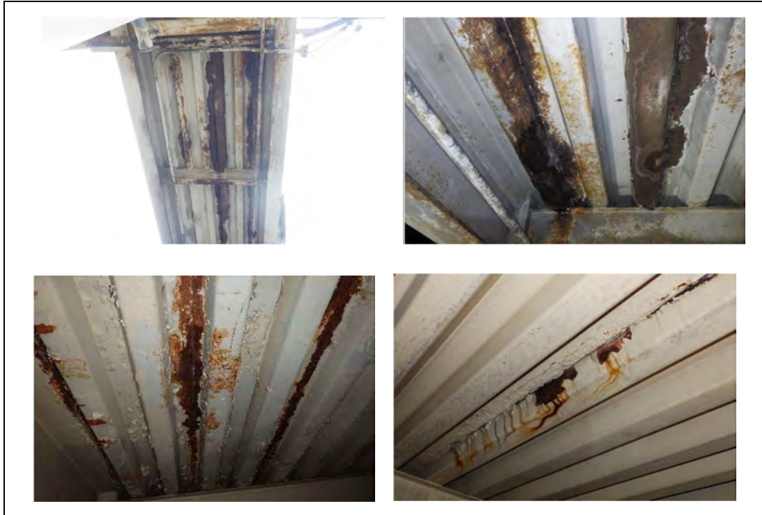
損傷の面積が大の例（拡がりのある発錆箇所が複数ある例）
