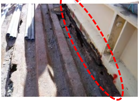
※ 舗装を除去した後の地覆の状態
