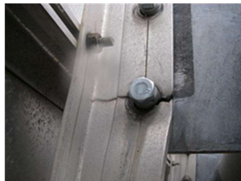
取付部の変状状況
