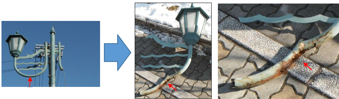
図-2. 1 特徴的な部分の腐食が進行した例
