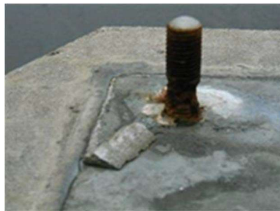
図－6．2 転用部材のアンカーボルトの変状事例
