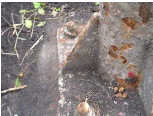
路面境界部が土砂で覆われている場合
