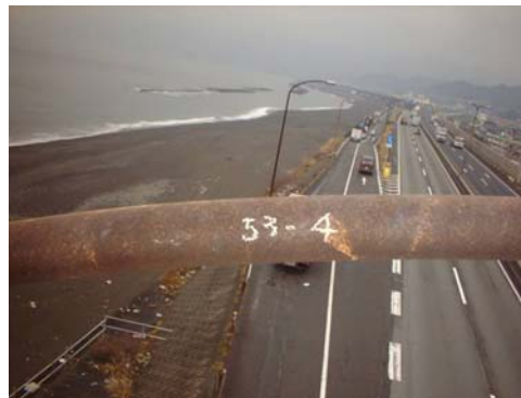
写真-解 8-11 支柱本体の腐食事例
