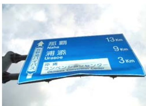
道路標識板の変状状況
