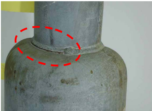
照明柱断面変化部の溶接に確認されたき裂 (歩道橋、15年経過)
