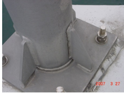
標識柱基部溶接部のき裂
