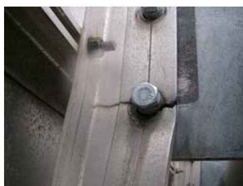
取付部の変状状況
