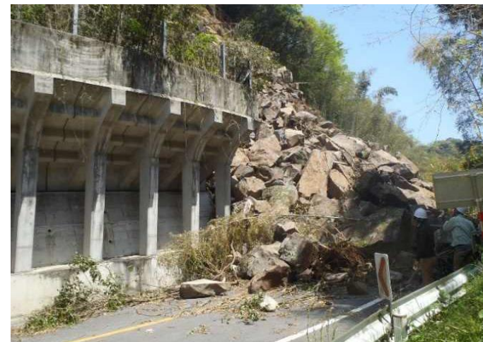
災害時における道路被害の事例
