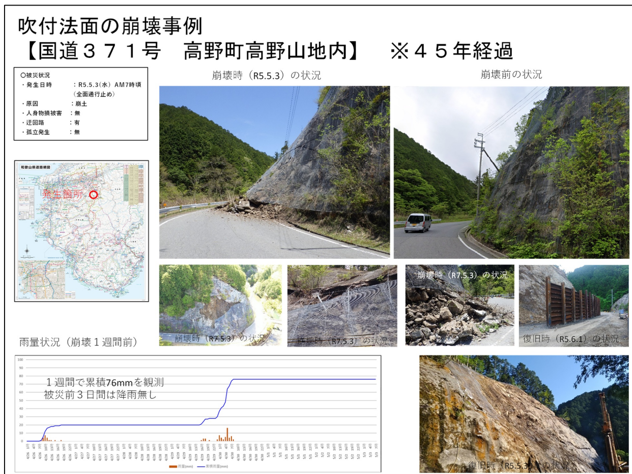
図-4.2.6 風化に伴う吹付法面の崩壊事例①（直近3年間の大規模な事例を抽出）
