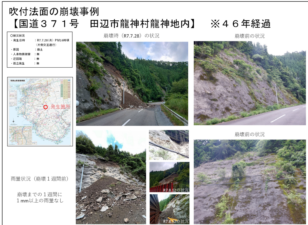
図-4.2.6 風化に伴う吹付法面の崩壊事例③（直近3年間の大規模な事例を抽出）
