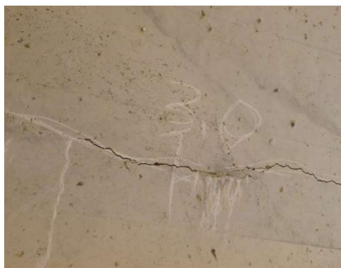
写真 2.6.1 覆工 (ひび割れ)
