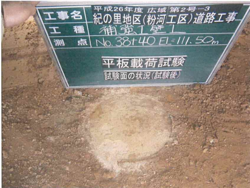
載荷面の状況(試験後)
