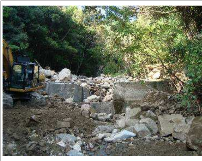
被災状況写真
