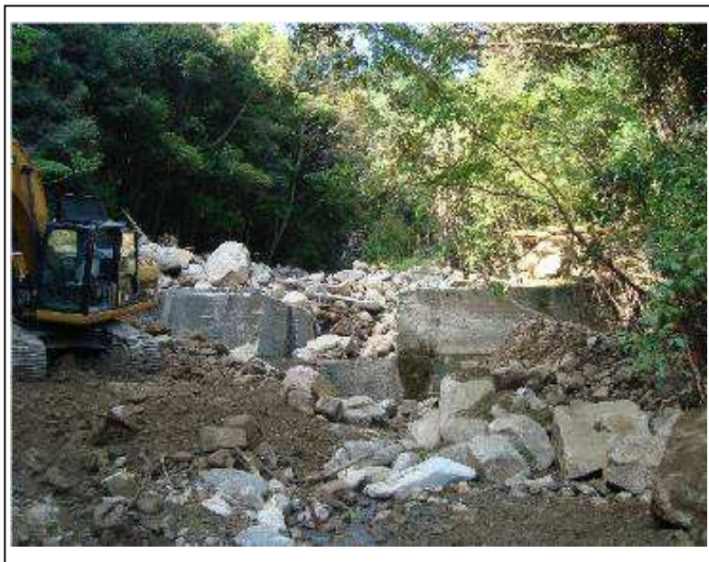
被災状況写真
