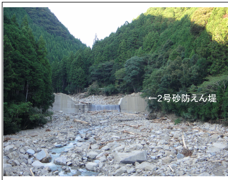
被災状況写真
