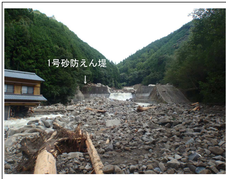
被災状況写真
