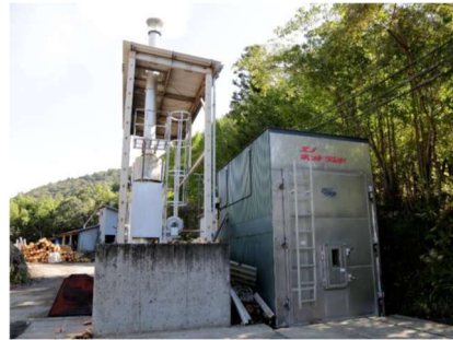
既存設備の高度化
