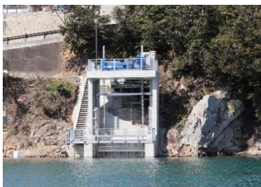
取水ゲートの遠隔操作
