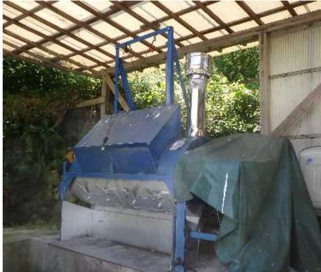
図4 加熱処理設備
