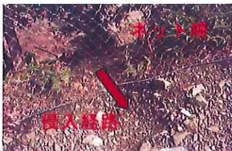
防護柵の下にできたシカの進入路
