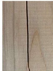
写真B (幅1mm程度の割れ)
