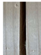
写真D (幅5mm程度の割れ)
