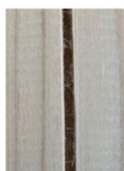
写真C (幅 3 mm 程度の割れ)
