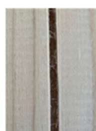
写真C (幅 3 mm 程度の割れ)
