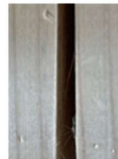
写真D (幅5mm程度の割れ)
