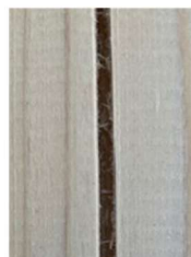
写真C (幅3mm程度の割れ)
