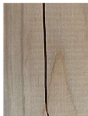
写真B (幅1mm程度の割れ)
