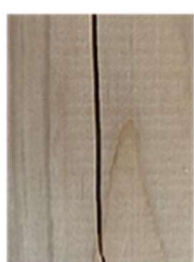
写真B (幅 1 mm 程度の割れ)
