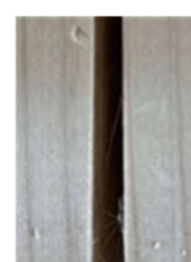
写真D (幅 5 mm 程度の割れ)
