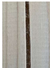
写真C (幅3mm程度の割れ)
