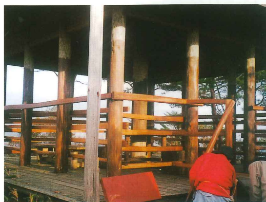
写真2 修繕後の展望施設 (内側の支柱に柵を施工し、防腐塗料を塗布)
