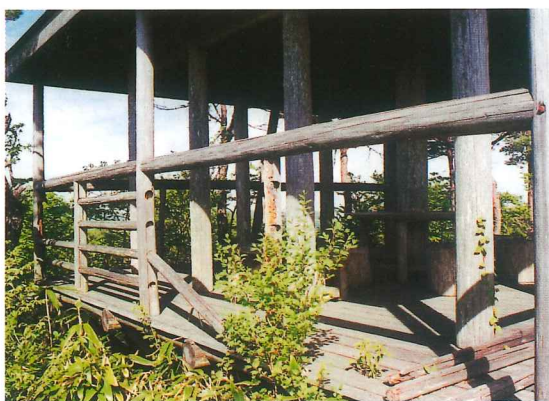
写真1 平成13年夏期における展望施設 (腐朽により、外周部分に施工されていた柵の横木の大部分がなくなっている)
