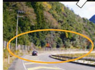
写真3 山間部の道路の金属製落石防護柵
