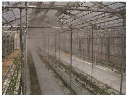
図1 外気導入型細霧冷房稼働状況
