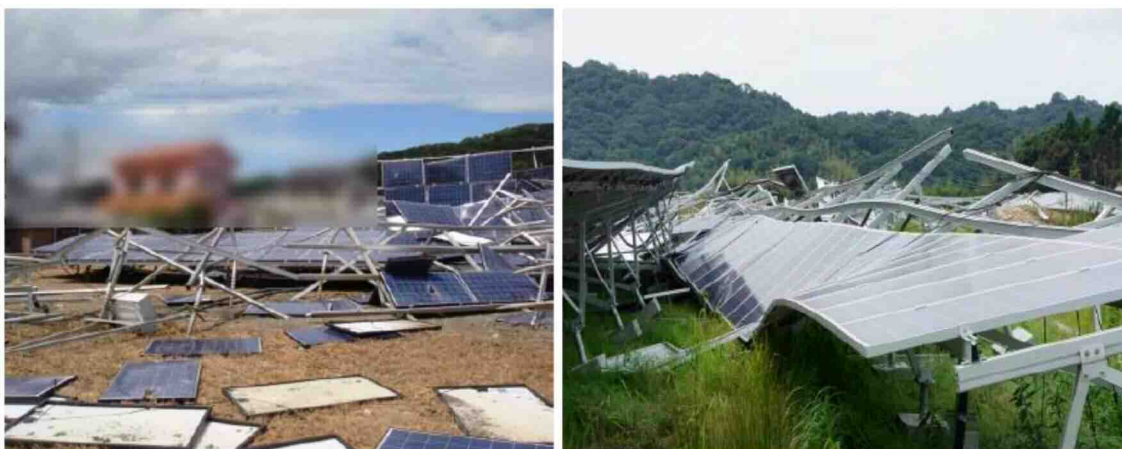
図表 3-2 パネル飛散の例（平成 27 年 8 月 台風 15 号によるもの）
