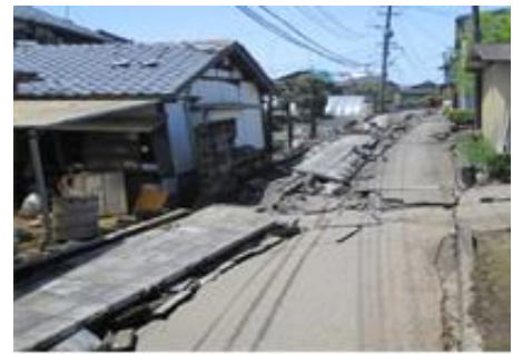
熊本地震で倒壊したブロック塀
