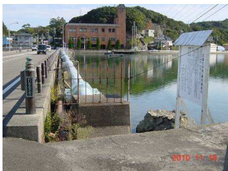
<写真は津波で落ちた霊泉橋:同時に水道管も崩落した>
