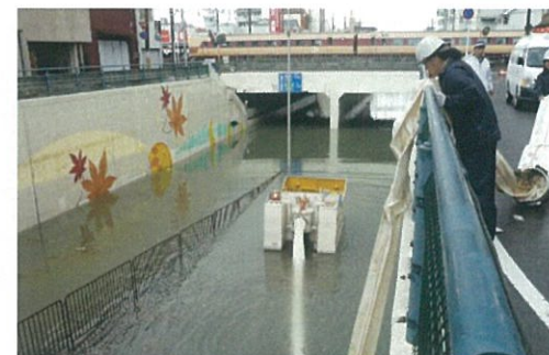
ポンプ車による排水状況
