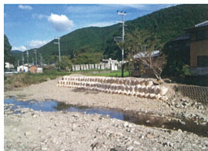
生馬川被災状況 (上富田町生馬地先)
