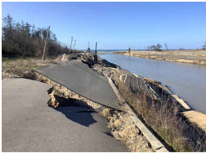
能登半島地震で寸断された道路
