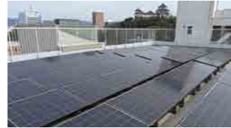
屋上に設置した太陽光発電設備
